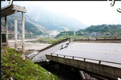
構造物の老朽化
