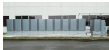
熊谷SSCの燃料電池発電システム
