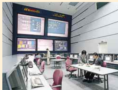
明石システムセンタの統合管制室
