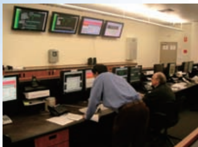
富士通オーストラリア保有データセンターの統合管制室
