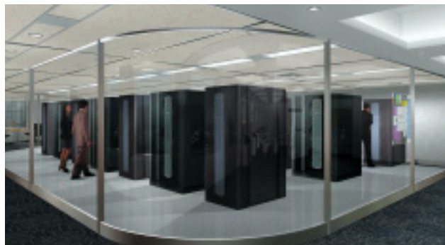
プラットフォームソリューションセンター サーバルーム (東京都港区)
