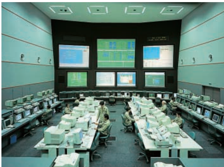
館林システムセンター／統合管制室
